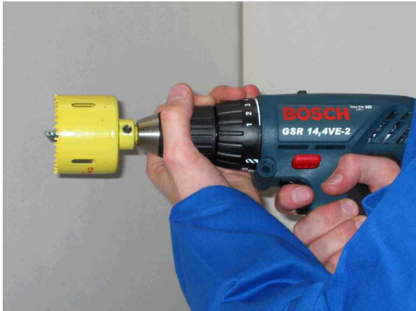
1. Montage de la scie cloche (dépassement de 1 cm du foret de centrage)
