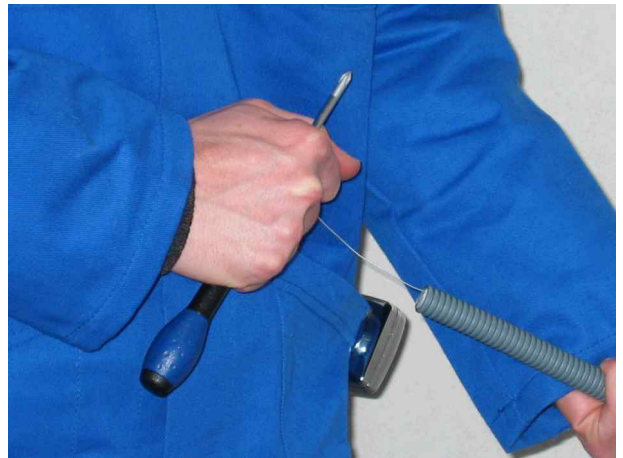
8. Il est possible maintenant de tracter l'aiguille en l'ayant au préalable accrochée à un tournevis (Remarque : Il est préférable d'être à deux pour cette étape, un qui tire sur l'aiguille et l'autre qui fait attention à ce que les conducteurs ne se croisent pas lorsqu'ils pénètrent dans la gaine).
